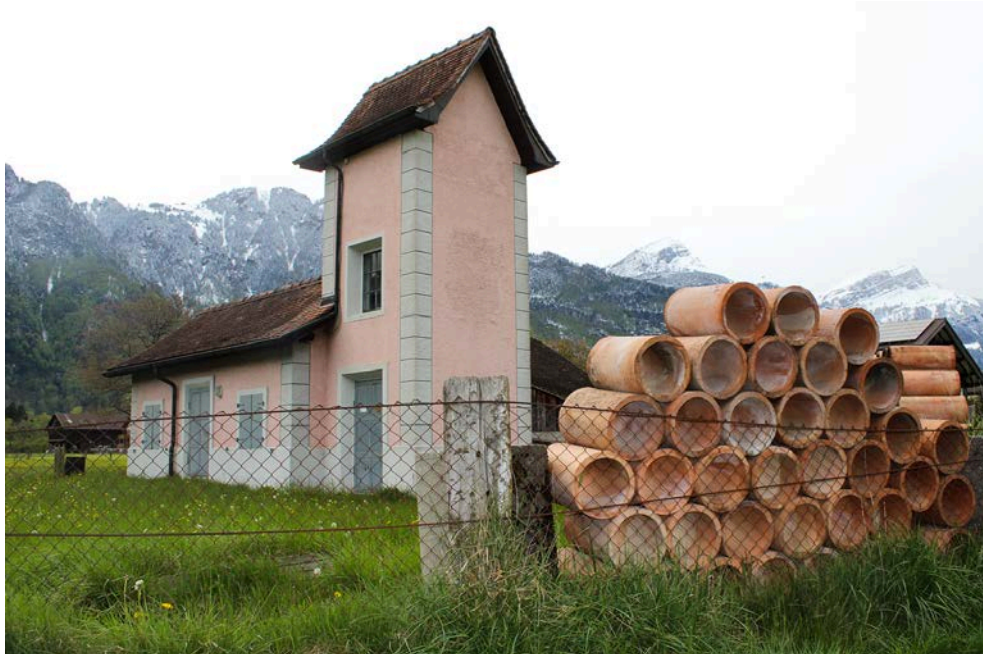
Station de pompage de la Meliorationsgenossenschaft avec poste de transformation (photo MGR)
