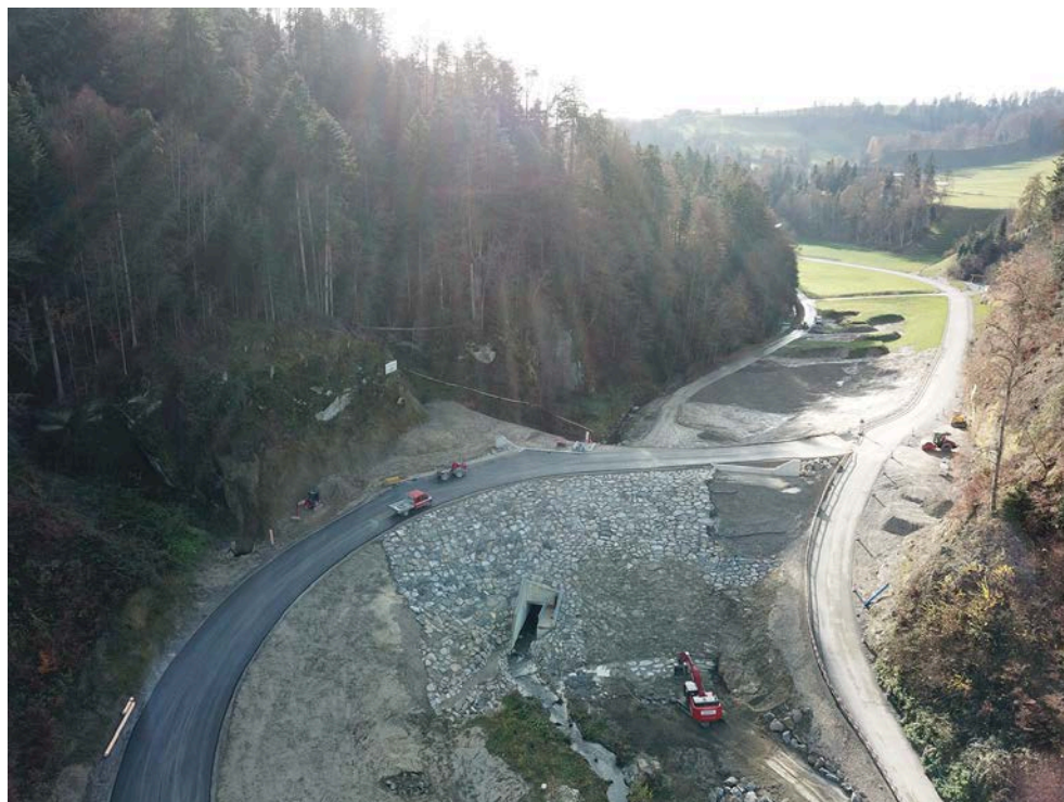
Vue du pan aval de la digue et du bassin de rétention (en haut sur la photo)
