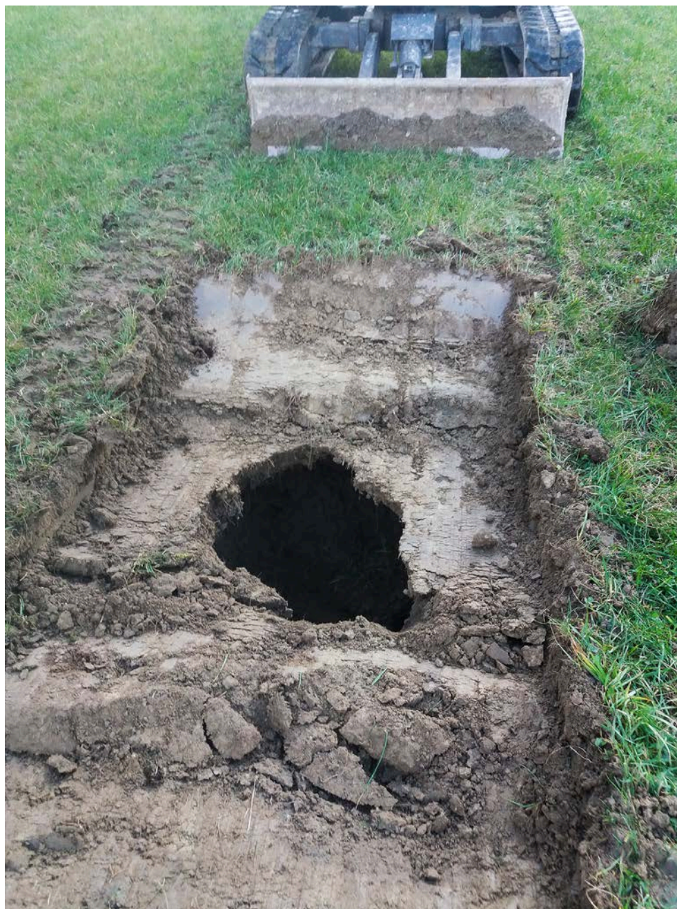
Trou dans le sol au-dessus d'un drainage, causé par de nombreuses années de rinçages (photo MGR)
